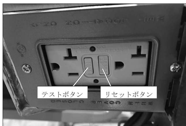
図9.5 - 電源コンセント
