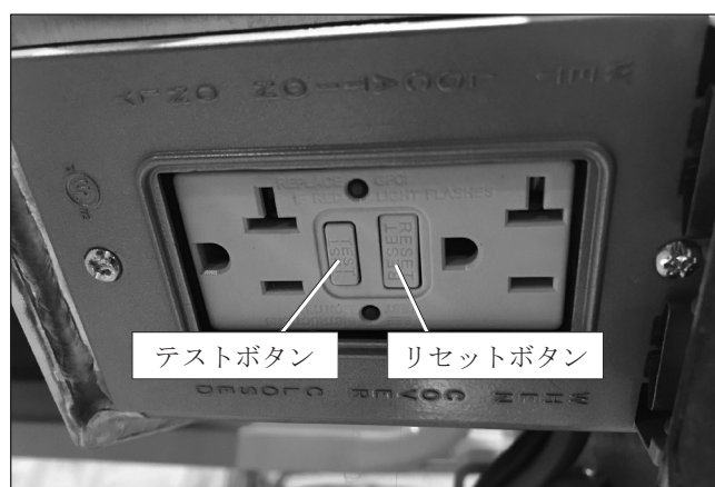
図8.17 - 電源コンセント
